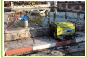
Dalgiç Pompanın Jeneratörle Birlikte Kullanılması
